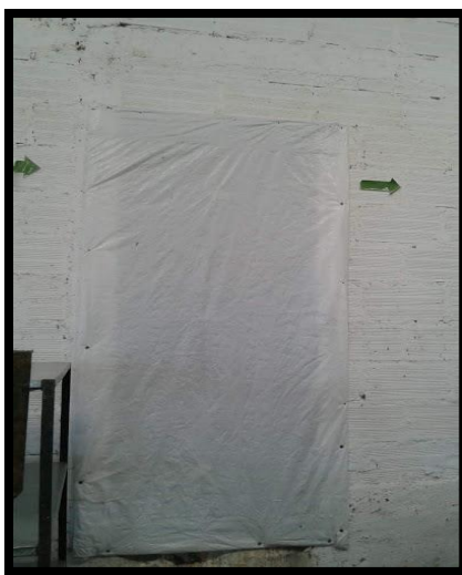
Figura 39. Sellamiento puerta que comunicaba área de clasificación con galpón # 2.
