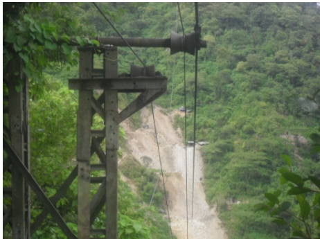
Ilustración 6 Cable transportador y gongola
