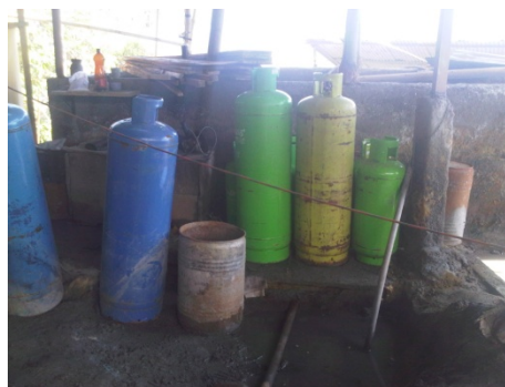
Ilustración 22 Almacenamiento del gas propano
