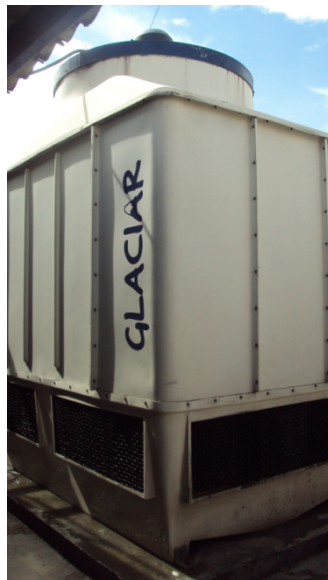
Foto 4. Torres de enfriamiento
