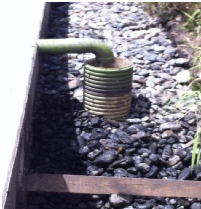
Figura 18: PTARD LF operando
