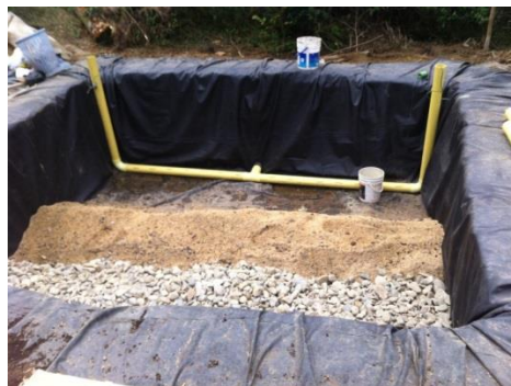
Figura 25: tubería de salida y llenado interno
