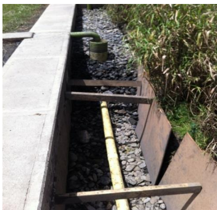
Figura 17: llenado del filtro de entrada
