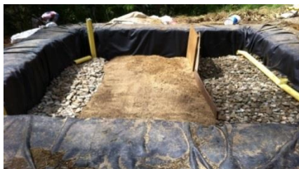
Figura 26: tubería de entrada y llenado interno
