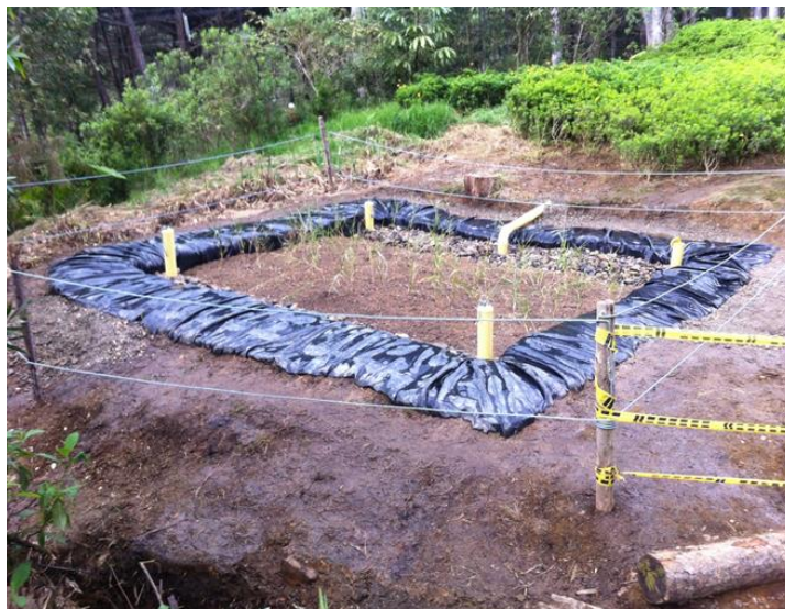
Figura 31: PTARD LF operando
