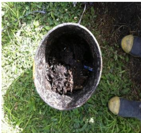
Figura 16: residuos sacados de la caja de bombeo
