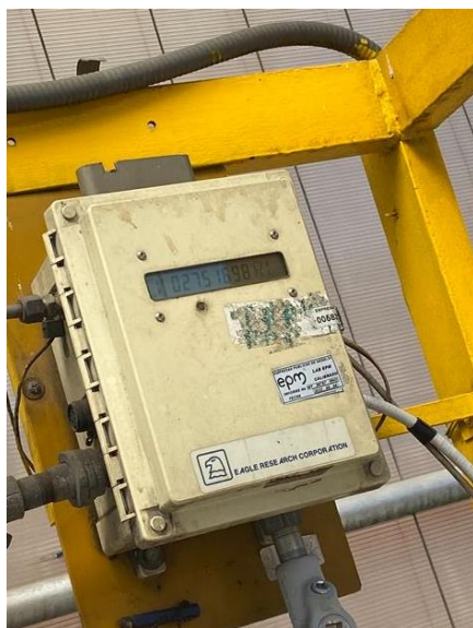
Figure 3 fotografía del medidor de gas.
