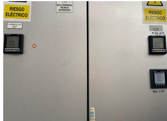
Figure 4 . fotografía de los medidores de energía del área de los compresores.
