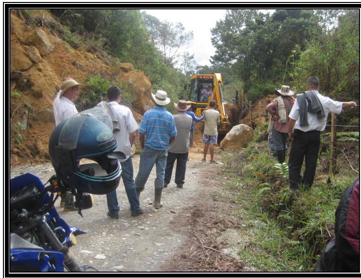
Figura 8. Afectación de la vía por deslizamiento en el Municipio de Concepción, Antioquia
