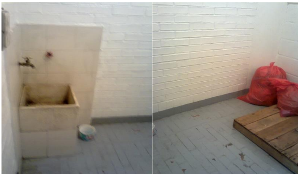
Foto 3. Cuarto de almacenamiento de RESPEL
