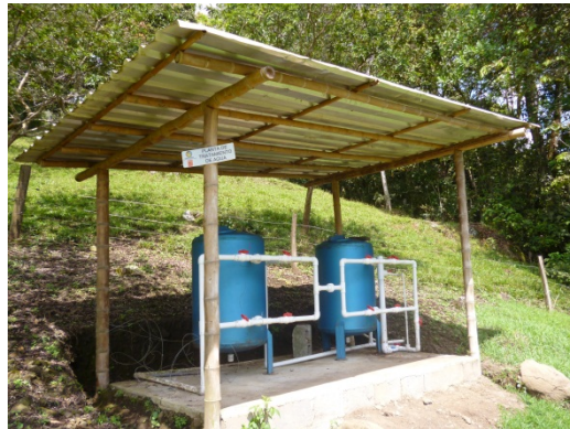
Imagen 21: Planta de tratamiento
