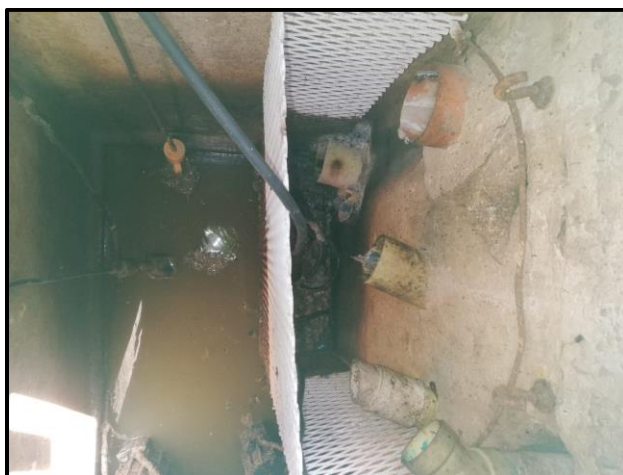
Foto 2. Registro del sistema de cribado.
