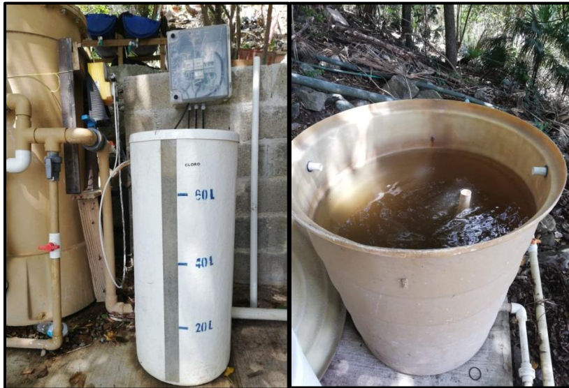
Foto 9. Tanque de Cloro y Tanque de Almacenamiento.
