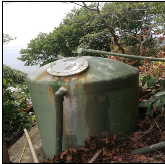
Foto 5. Tanque de Igualación.
