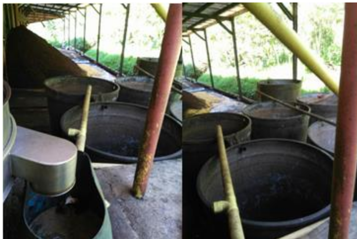
Ilustración 31: Aguas tamizadas y tanques pulmones. (Controlan el ingreso de aguas a la planta – 3,6 m 2 /hr)
