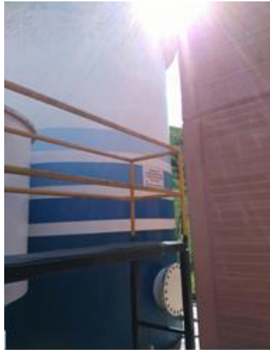
Ilustración 34: Tanque de homogenización y neutralización 40m 3
