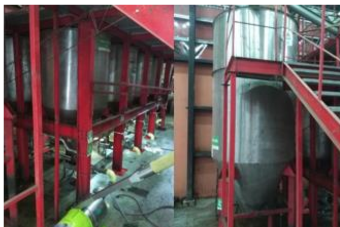
Ilustración 26: Tanques Ecomill (primera y segunda calidad) / tanque pasillas
