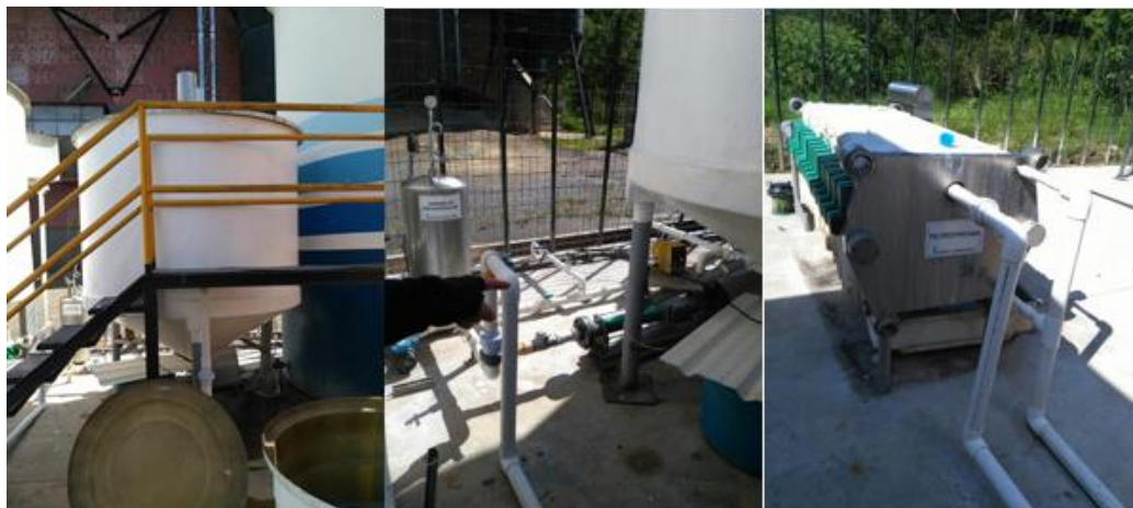
Ilustración 36: Tanque de lodos / sistema neumático / filtroprensa
