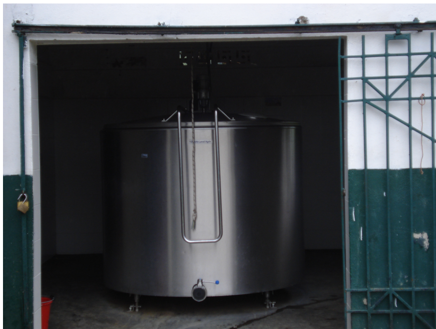
Foto 3. Sala de tanque de enfriamiento.
