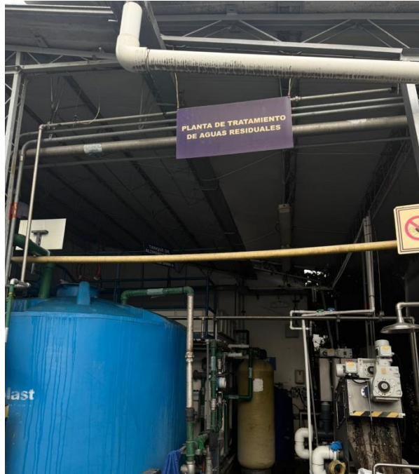
Ilustración 2. Fotografía de la Planta de Tratamiento de Agua Residual no Doméstica (PTARnD).
