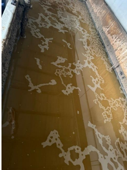
Ilustración 5. Fotografía del reactor aerobio.
