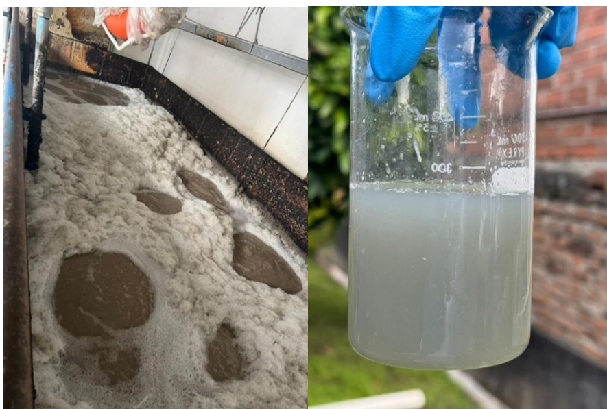
Ilustración 12. Fotografía y muestra del tanque reactor aerobio (color gris)
