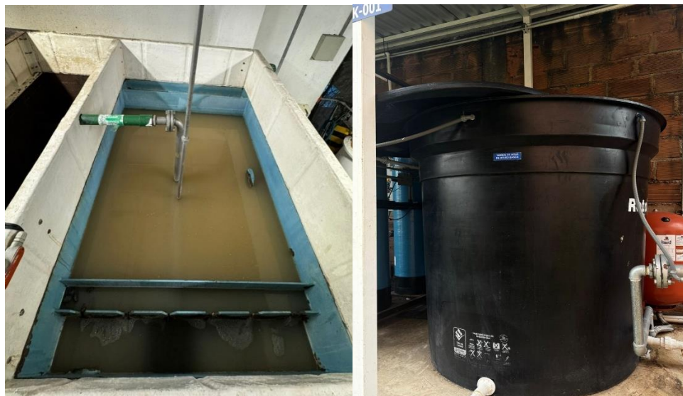
Ilustración 6. Fotografía tanque sedimentador y tanque agua de reúso.
