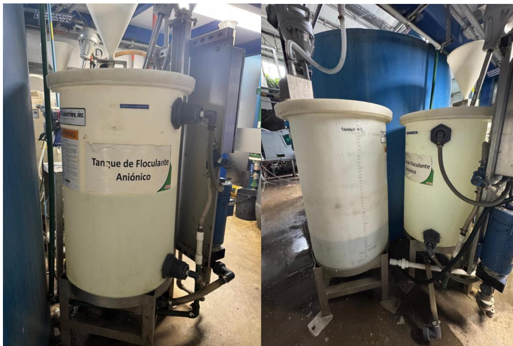
Ilustración 10. Incorporación tanque auxiliar de floculante aniónico
