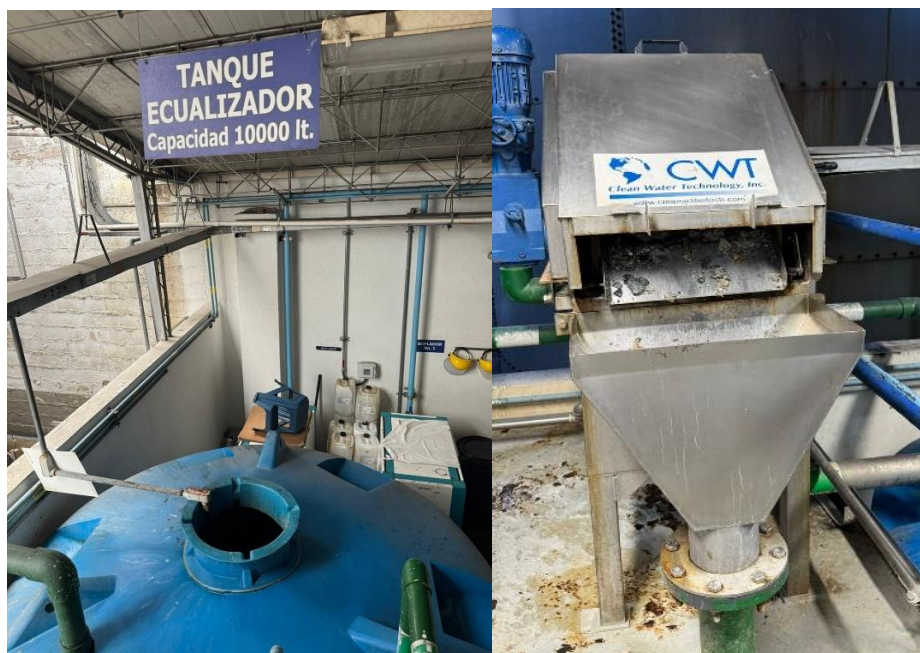
Ilustración 3. Fotografía del tanque ecualizador de entrada y el sistema de cribado.
