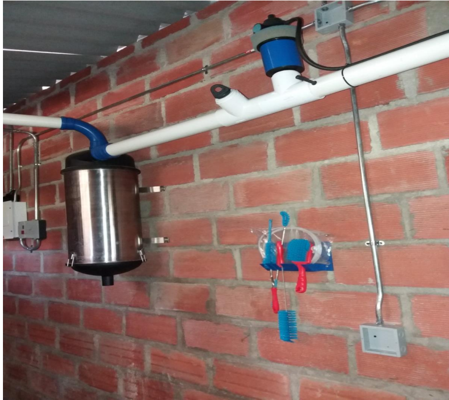
Foto 12. Filtros y Conductos.
