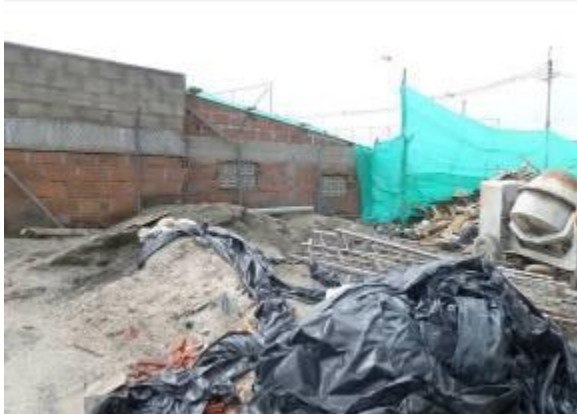
Foto 41. Disposición inadecuada de RCD Edificio Altos del Lago
