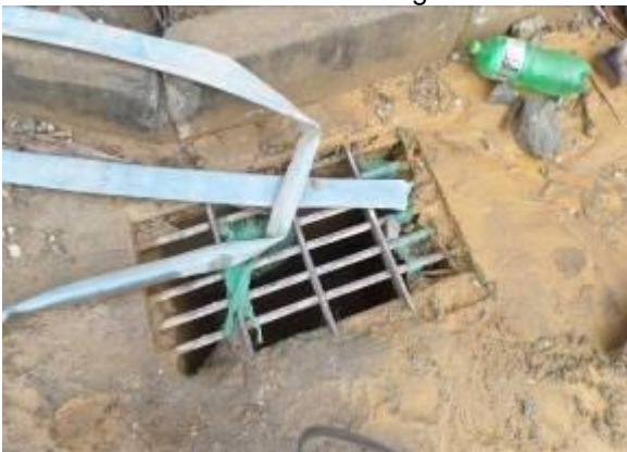
Foto 45. Afectación de sumideros por arrastre de Sedimentos Edificio Altos del Lago
