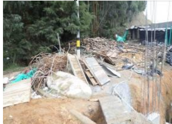
Foto 44. Disposición inadecuada de RCD Edificio Altos del Lago
