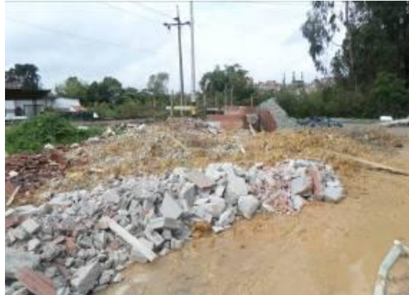
Foto 42. Disposición inadecuada de RCD Edificio Altos del Lago
