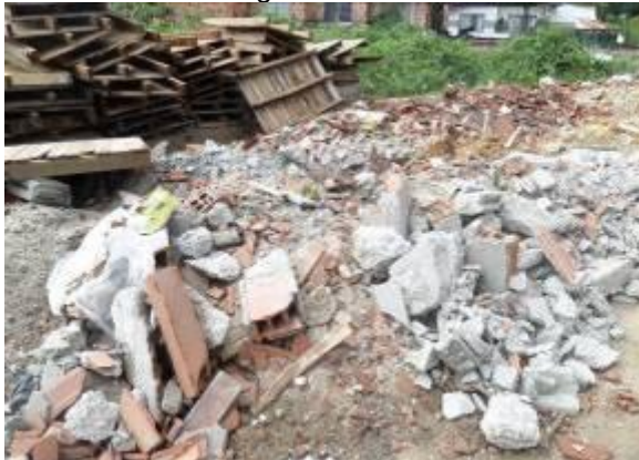
Foto 43. Disposición inadecuada de RCD Edificio Altos del Lago
