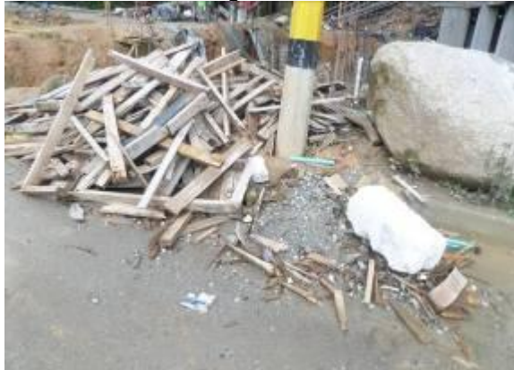
Foto 40. Disposición inadecuada de RCD Edificio Altos del Lago
