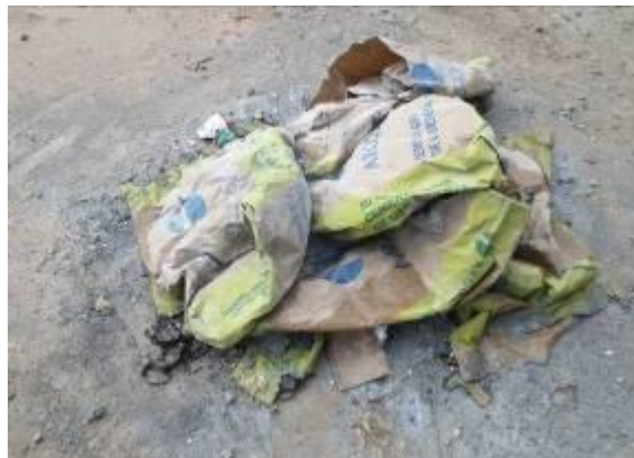
Foto 46. Disposición inadecuada de RCD
