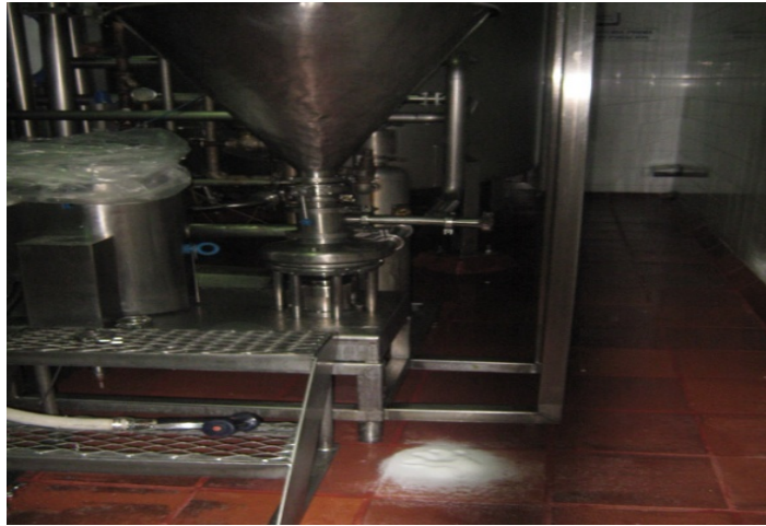
Figura 4. Fuga en la tolva
