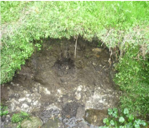
Imagen 28 Erosión en canales de drenaje
