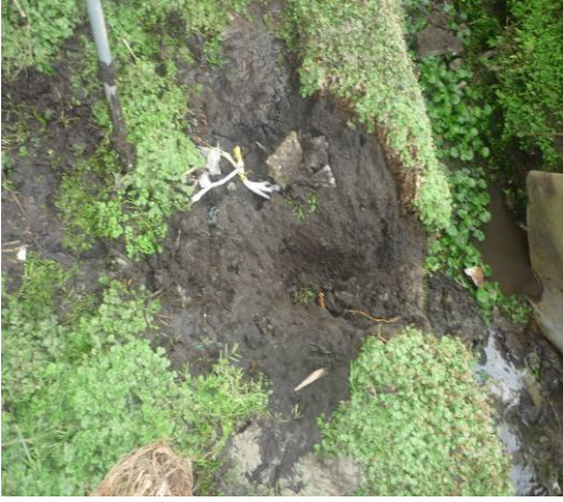
Imagen 26 Erosión por lluvia parte superior
