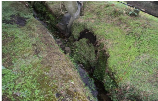
Imagen 22 Erosión canal de drenaje bloque 13
