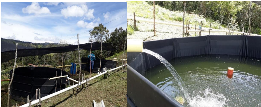
Figura 7. Tanques y tubería.
