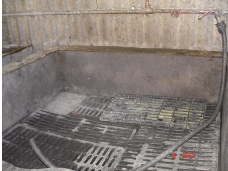
Figura 21: Estado de las pocetas en la zona de lavado de estructuras.
