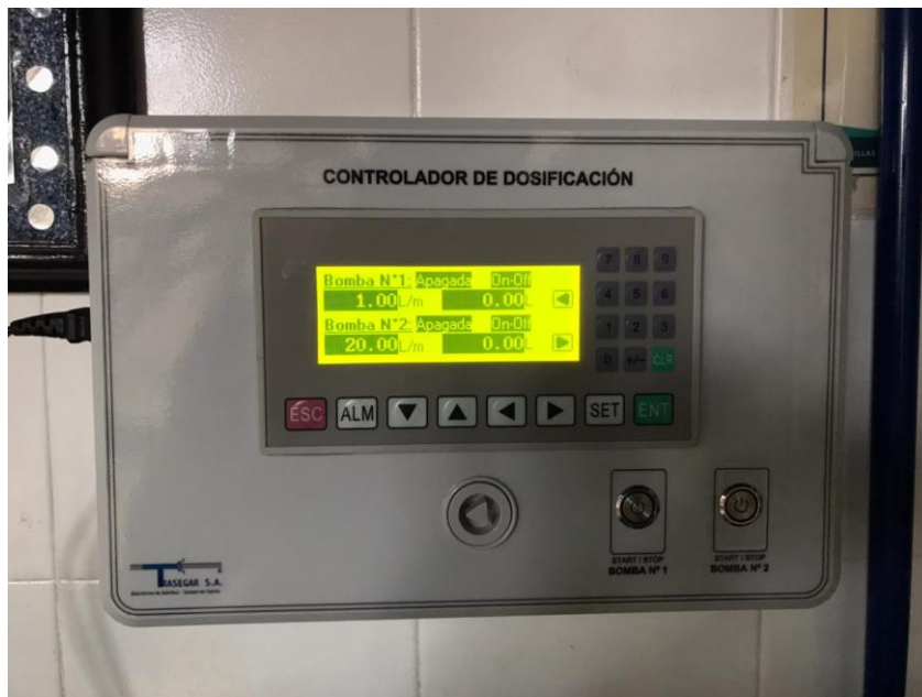
Imagen 12. Tablero controlador de bombas dosificadoras
