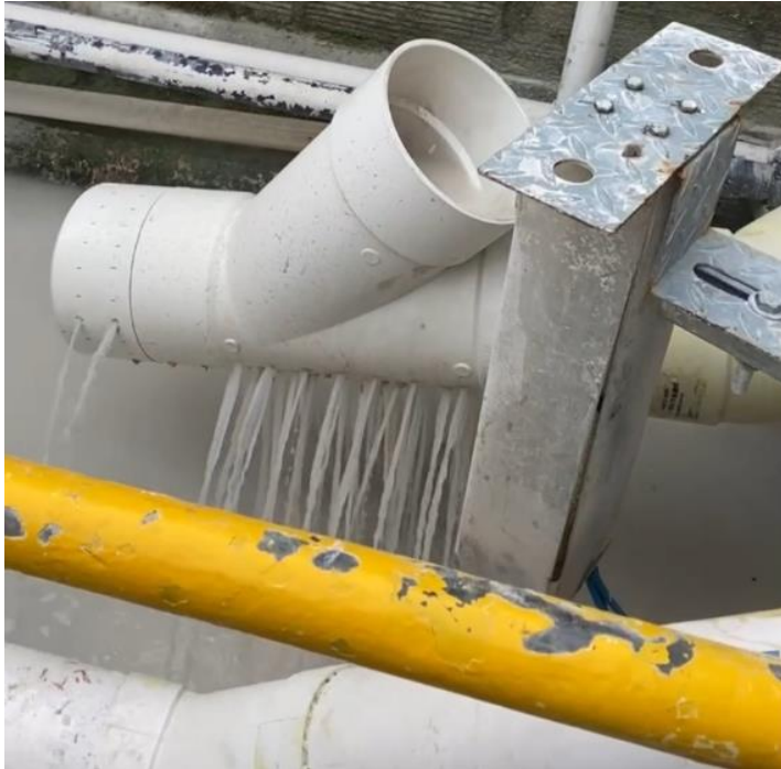
Imagen 8. Reductor de velocidad en el canal de entrada
