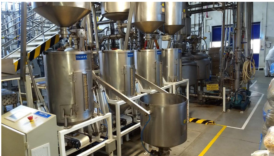
Ilustración 5. Imagen tolvas de dosificación en planta.
